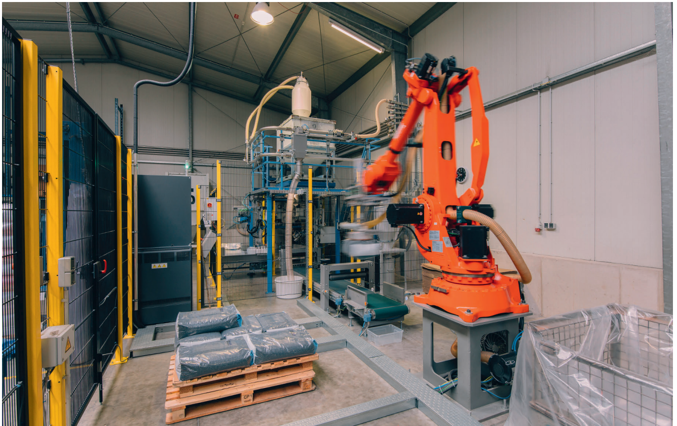
In der Anlage kommt ein sechssachsigter Roboter zum Einsatz, der die Säcke vom Pufferplatz entnimmt und palettiert oder wahlweise Rohware depalettiert (© Michael Adamski)
